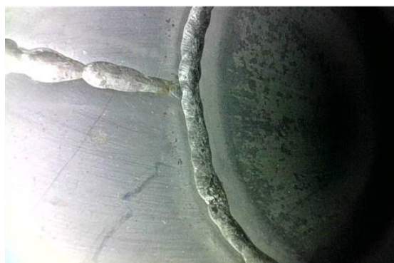
Рис. 9. Корень сварного шва в трубопроводе
