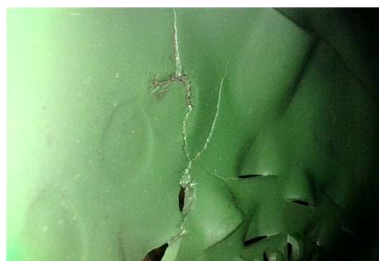
Рис. 7. Трещина на жаровой трубе КС АД
